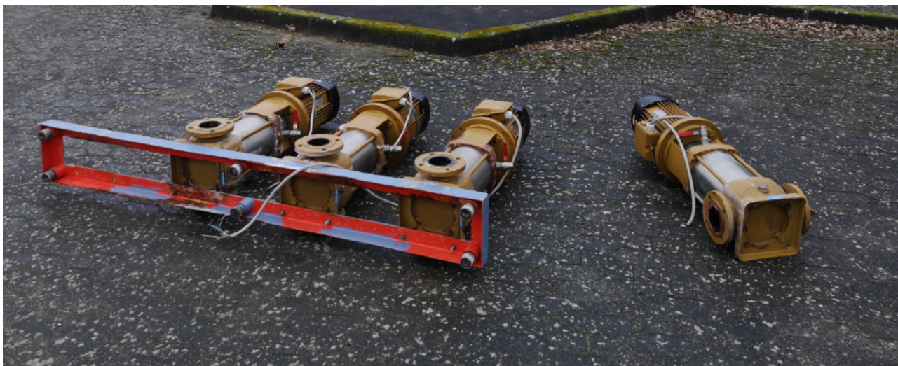
De fire gamle pumper der er afmonteret
