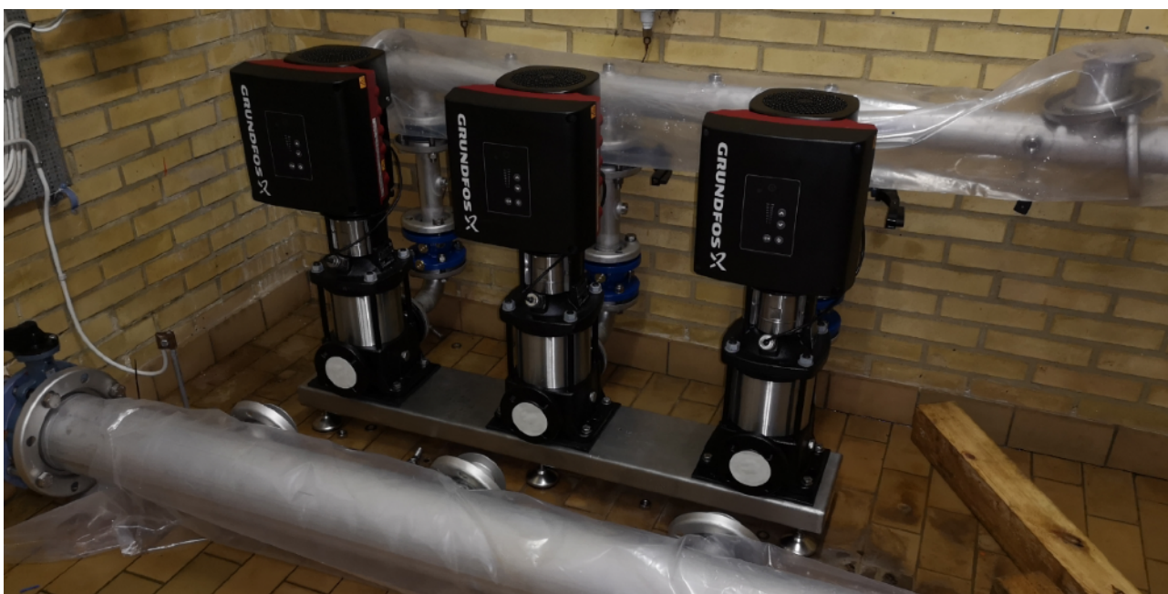
De tre nye pumper der i dag bringer vandet ud til forbrugerne
